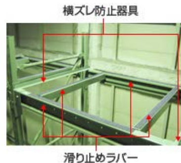
落下防止を施した、パレット保管設備
